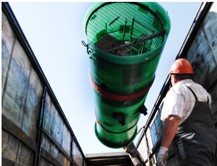
г. Бобров, насосная станция, производственное предприятие
